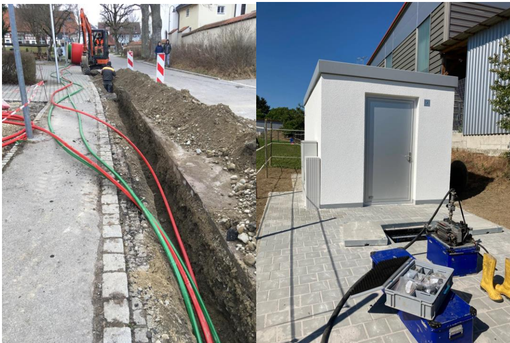
POP Standort im Gewerbegebiet Brühl
